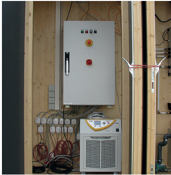
Abb. A5 Schaltschrank, Messumformer Kryostat (THN-AR)
