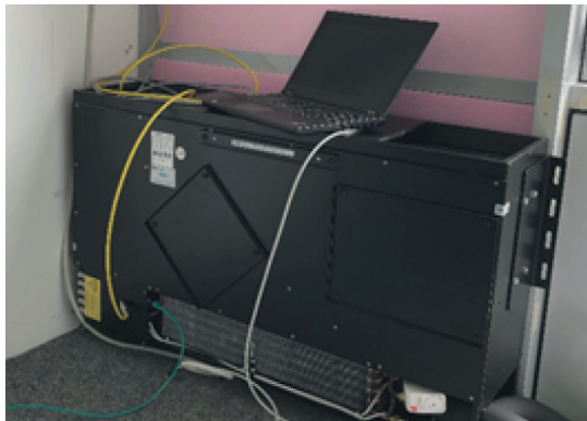
Abb. 74 Innenansicht des DFL-Gerätes während der Inbetriebnahme (IBP)
