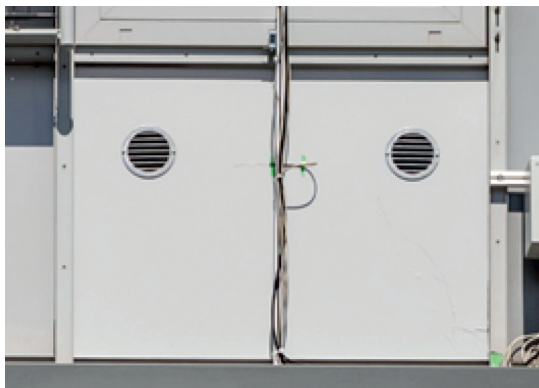
Abb. 76 Frischluft- und Fortluftöffnung mit Insektenschutzgitter (IBP)
