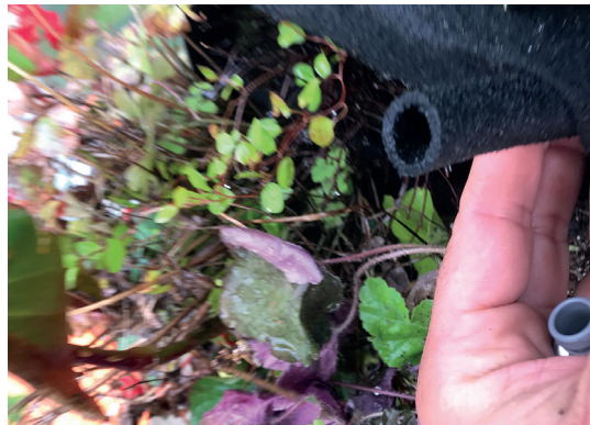
Abb. A38 Schaden an einem Bewässerungsschlauch (IBP)
