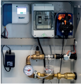
Abb. 83 Schaltschrank zur Bewässerungssteuerung (IBP)
