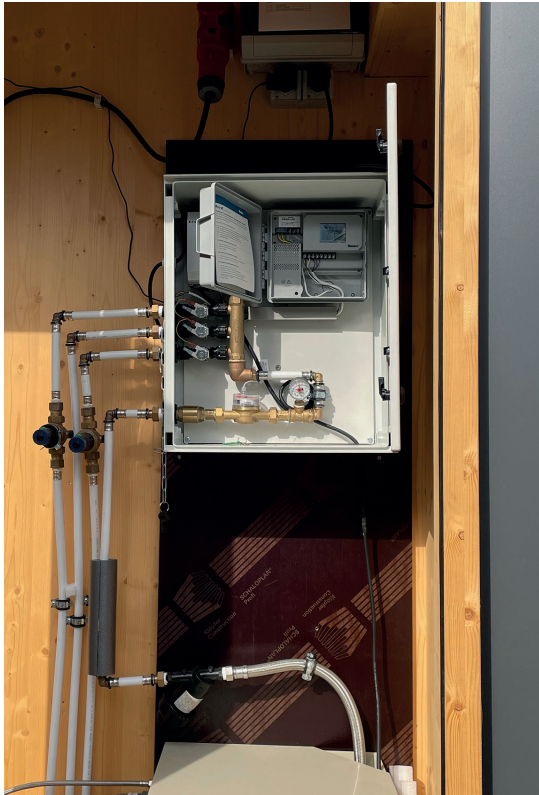
Abb. A18 Rednitzhembach, Technikum/ Fassadenversuchsstand – Bewässerungsanlage (THN-AR)
