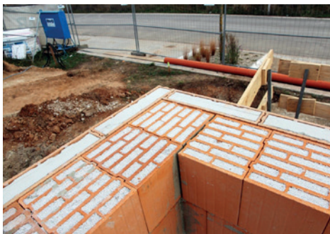
Abbildung 2: Zweischalige Bauweise aus Perlit-gefüllten Ziegeln (Innenseite) und einer zwölf Zentimeter dicken Wärmedämmfassade aus Calostat-gefüllten Vorsatzziegeln [Quelle: TH Nürnberg]
