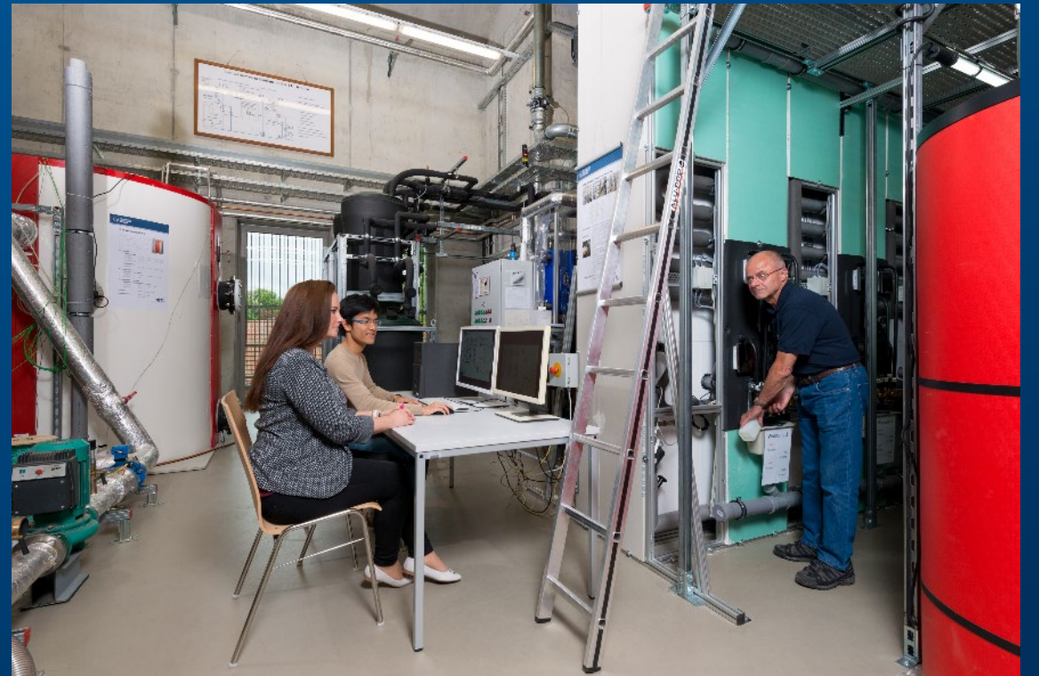
Zentrum für Energietechnik der TU Dresden Versuchsfeld Rationelle Energieanwendung/Regenerative Energien mit TWI-Versuchstand – Emulation Mehrfamilienhaus 6 WE
